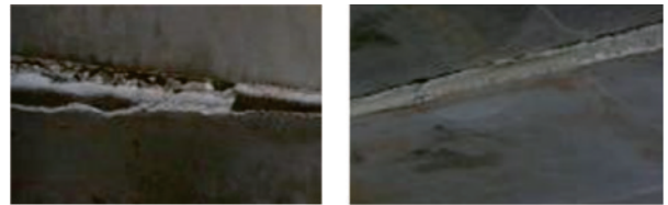
图 19 铰缝实际状态
